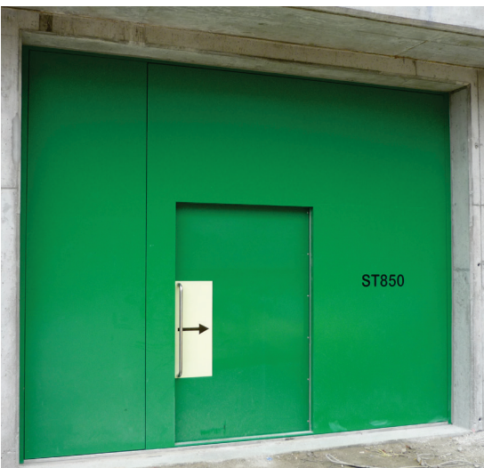
Schleusentor Abschluss SISTO mit Fluchtschiebetüre
